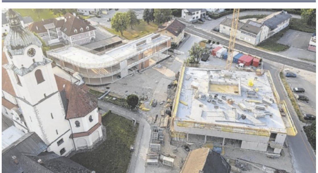
Das Ortszentrum von Sattledt ist nach der Fertigstellung der beiden Kommunalgebäude maßgeblich umgestaltet. Foto: TV1
